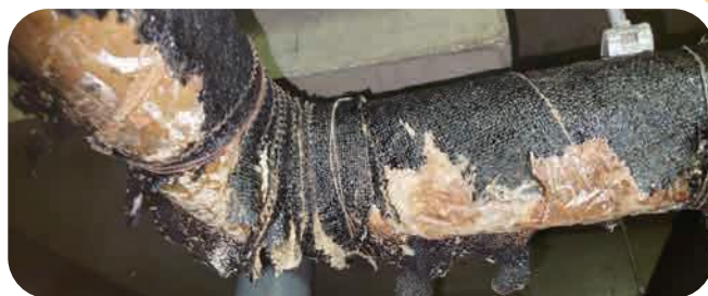
老朽化した配管
